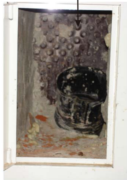
Дренажное полотно смонтировано неправильно
